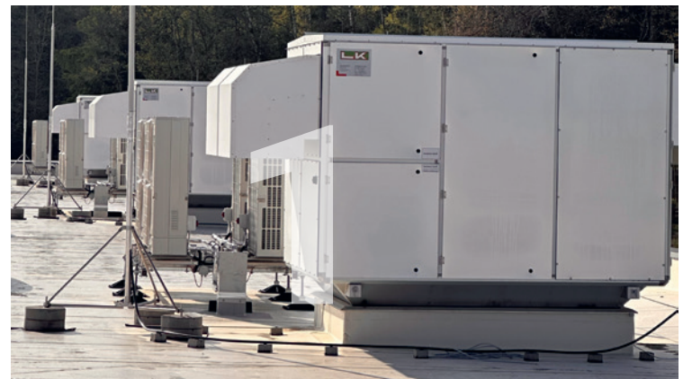
LK Lüftungsanlage REKU 10 mit Wärmepumpen
